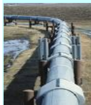
Αγωγός φυσικού αερίου
